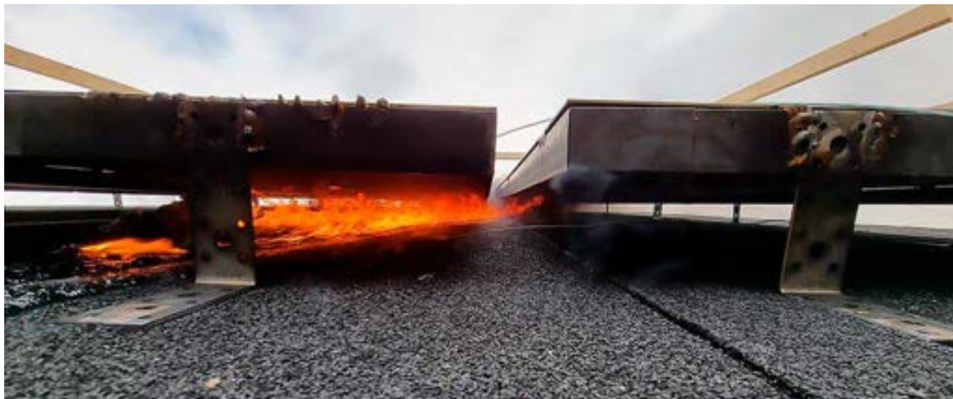
Solcelleanlegg skal kun installeres av en faglært elektriker, da anlegget produserer høye spenninger og kan forårsake brann ved feilmontering.
