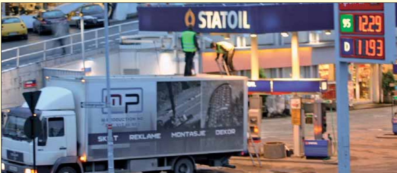
Livsfarlig arbeid hos Statoil. Arbeidet 5–6 meter over bakken uten sikring.
